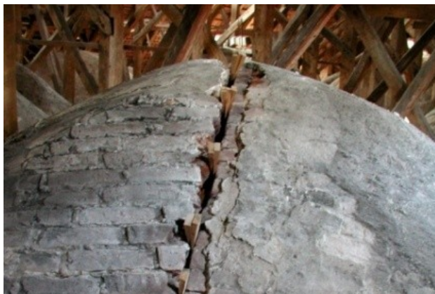
Schäden an der Kappe
