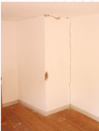
Riss im Obergeschoss
